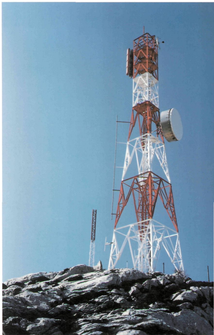
Torre de control del Centre de Telecomunicacions de l'Associació Voltor a la serra d'Alfàbia que permet la recepció a les Balears de totes les emissores de ràdio i televisió en llengua catalana. Les noves tecnologies obren perspectives inèdites a l'espai comunicatiu comú (Foto Obra Cultural Balear)
